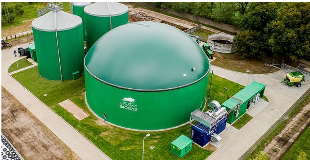
Εικόνα 31 Μονάδα παραγωγής βιοαερίου
