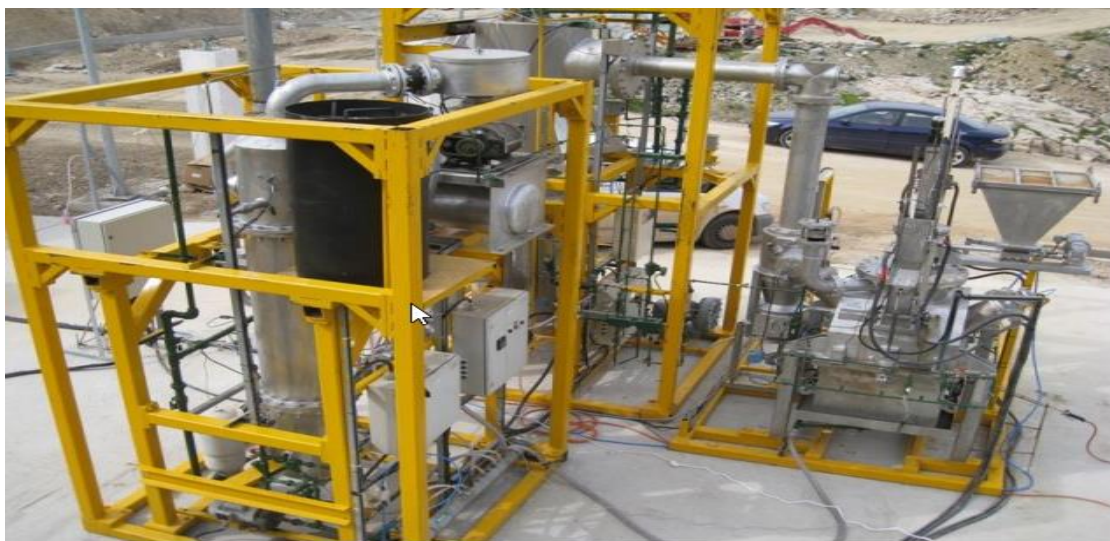
Εικόνα 11 Πιλοτική Μονάδα αεροποίησης/υαλοποίησης
